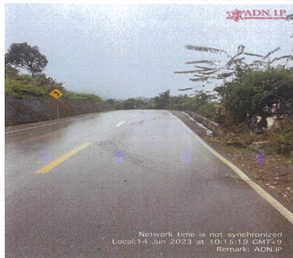
Kondisaun Estrada Sarai – Ainaro Vila
