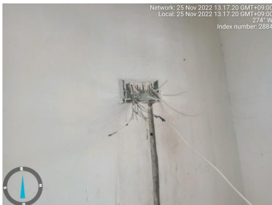
Foto : Kabel listrik
