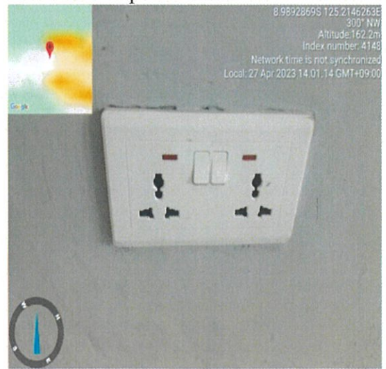
Foto : Servisu power outlet
