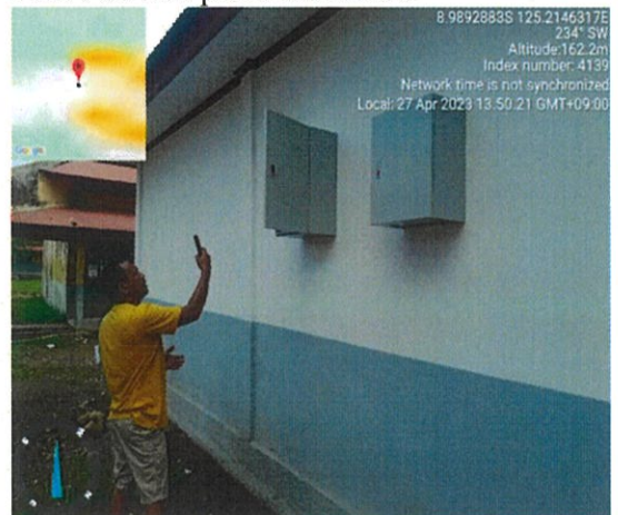
Foto : servisu panel box listrik
